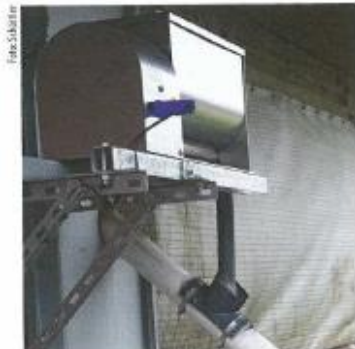
Das Einmischen der Pflanzenkohle ins Futter erfolgt auf dem Betrieb mittels Dosiereinrichtung in das Futterrohr.
